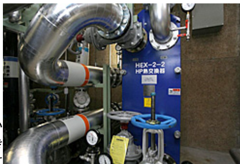
洞爺湖の温泉廃湯ヒートポンプ (日経BP社HP)
