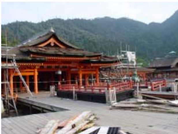
厳島神社本社拝殿、高舞台、平舞台の被害(丸山撮影)
