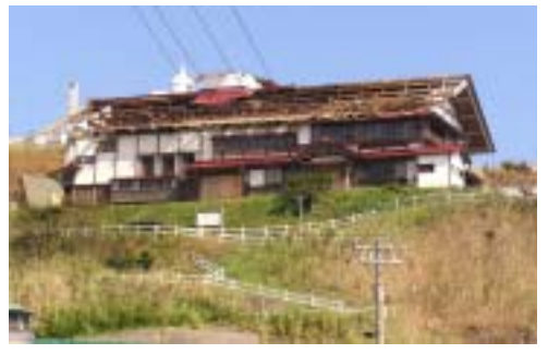
小樽市鯉御殿の被害(小樽市建築課提供)
