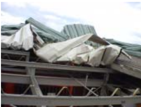
神戸の倉庫建築物の被害 (西村撮影)
