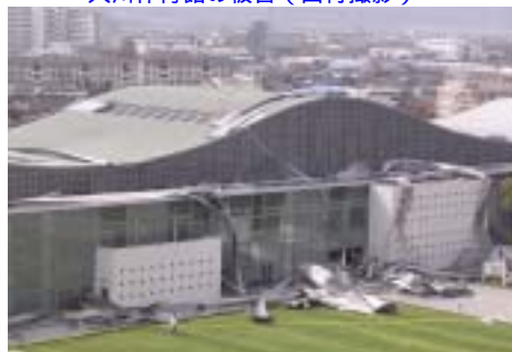
山口情報芸術センターの被害（藤川撮影）
